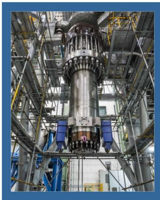
Oben abgebildet ist eine KSB-Reaktorkühlmittelpumpe. Quelle: KSB SE & Co. KGaA, März 2023.
